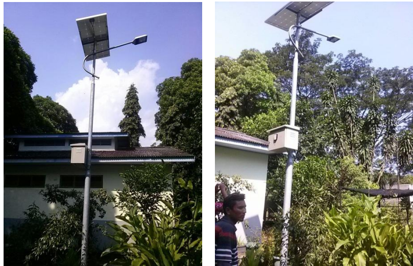
Gambar 4.2 Instalasi Solar Cell di SMA Negeri 1
